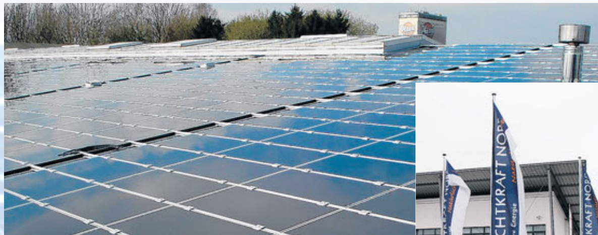
Eine Photovoltaik-Anlage der Lichtkraft Nord.
