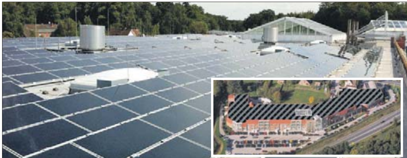
Von außen ist die 1500 Quadratmeter große Photovoltaikanlage auf dem Dach des Einrichtungszentrum Konken nicht zu erkennen. Die 2000 Module wurden von der Firma Lichtkraft Nord aufgebaut.
