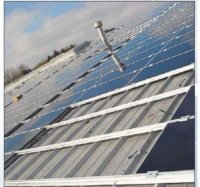
Nach individueller Beratung erfolgt die fachmännische Montage und Inbetriebnahme. Alles aus einer Hand.
