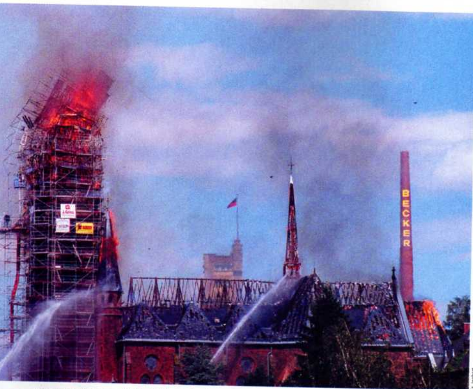
Ein Feuer zerstörte im Juli 2007 den Dachstuhl der Kirche in Sankt Ingbert. Über ein Sozialaufgeld, das die 1. Sankt Ingberter Bürger-Solar-Genossenschaft erhebt, wird die Sanierung mitgetragen.
