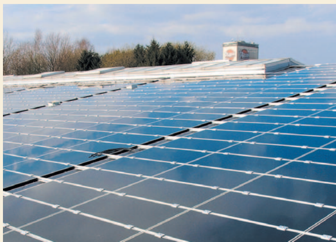
Auf der Südseite des Werkstattdaches des Autohauses Südbeck erzeugt die neue Photovoltaik-technik 53 376 kWh im Jahr und vermeidet dadurch 47 Tonnen Kohlendioxid (CO 2 ).
